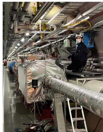
図2 LHCのトンネルの中
